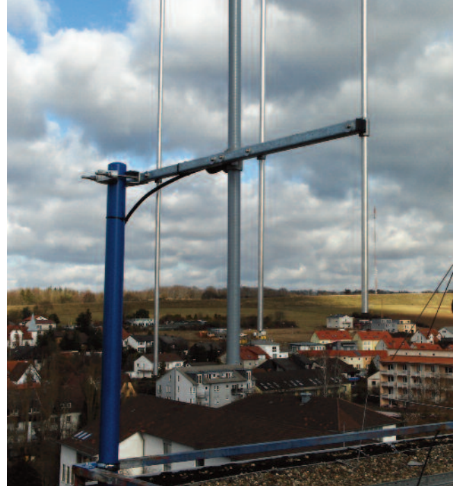
Der Sender auf dem Dach des B-Gebäudes der FH (Foto: FH)
